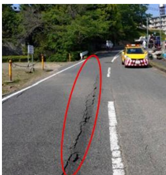
図4. 路面のひび割れ
